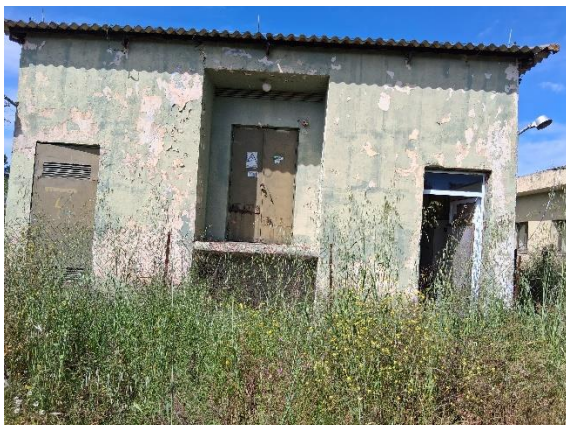
ΥΠΟΣΤΑΘΜΟΣ ΔΕΗ (No 9)
